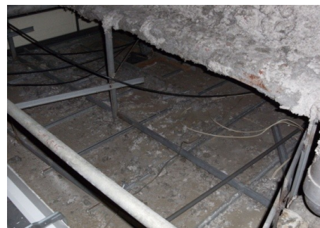
天井に堆積したアスベスト
