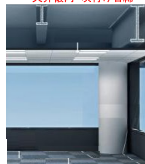
天井懐内 吹付け石綿
